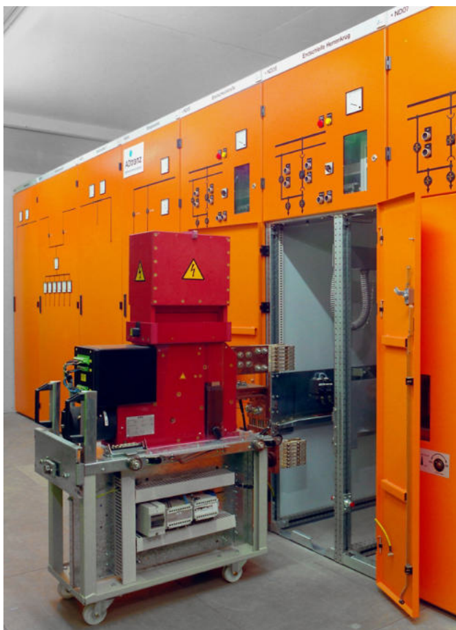
Подстанция постоянного тока с выкатной версией автоматов Gerapid 2607
